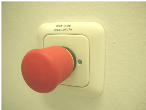
Notabsperung für Gas, am Laboreingang und vorne rechts an allen Funktionsboxen
